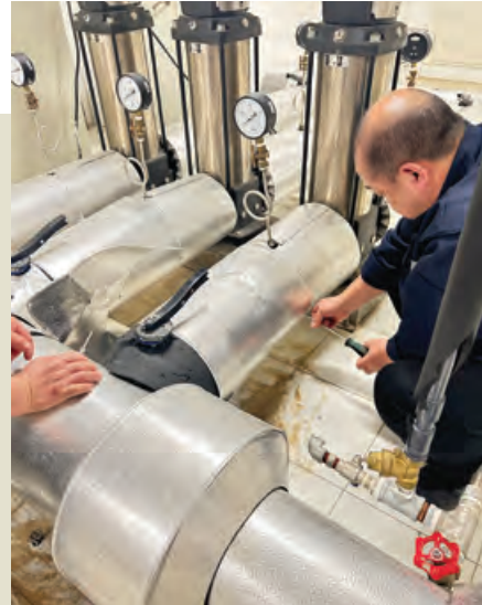
工程師正在檢查北京東方君悅大酒店的水泵及空調系統
